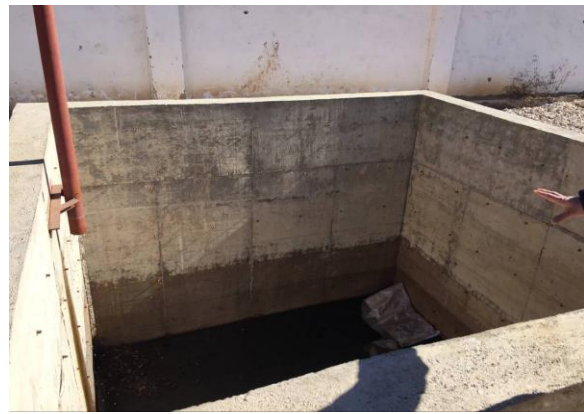
图 9 生活污水收集池
