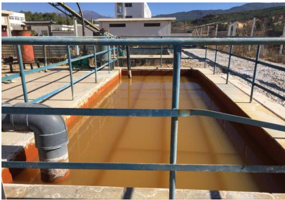
图 10 工业废水处理站
