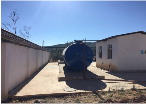
图 8 一体化生活污水处理站
