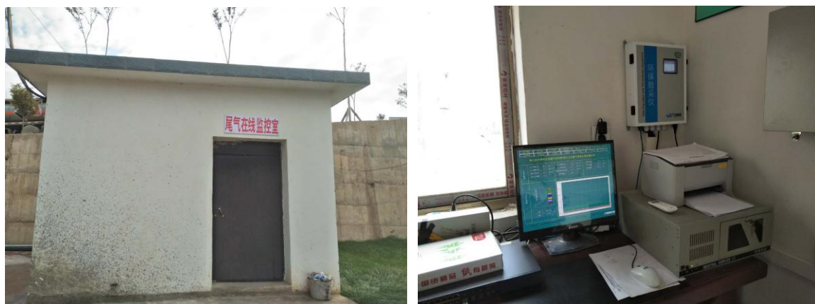
图 2 在线监测控制室及监控设备
