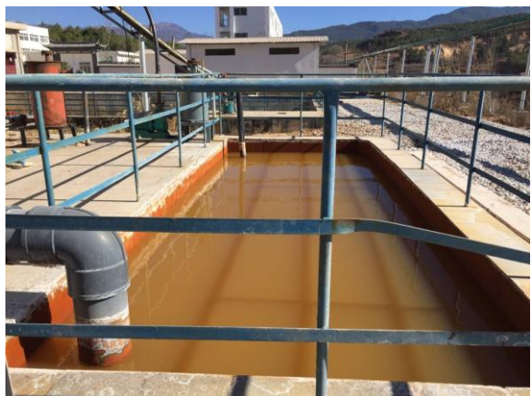
图 3 工业废水处理站
