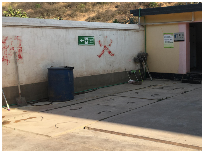
化粪池及油水分离池
