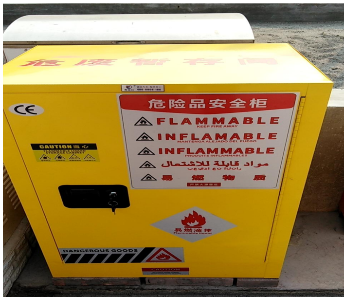
危险废物暂存柜
