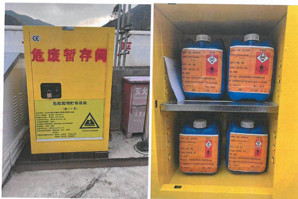
整改后危废暂存柜照片
