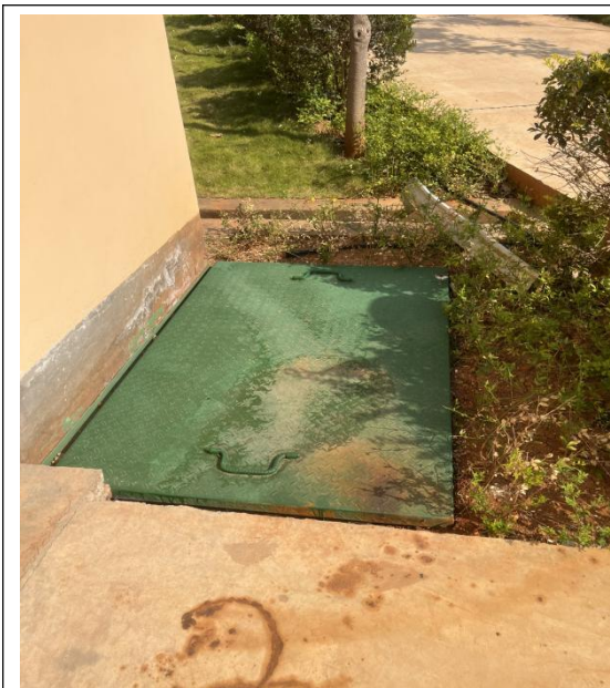
消毒间事故收集池
