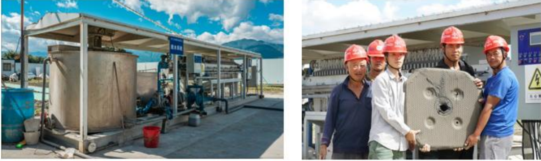
图 3.1.1-2 海舌实验基地的脱水设备及脱水泥饼
