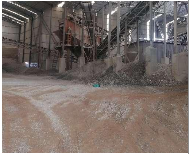
生产车间生产线
