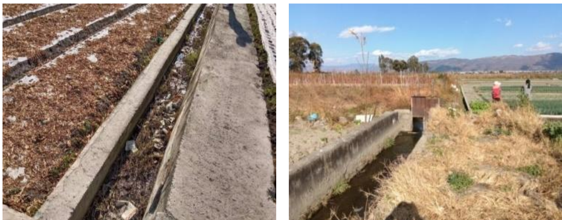
图 2.2-3 项目区沟渠现状问题
