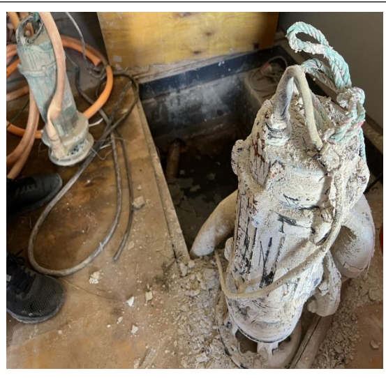
三级沉淀池回水泵（间歇使用，使用时放入三级沉淀池）
