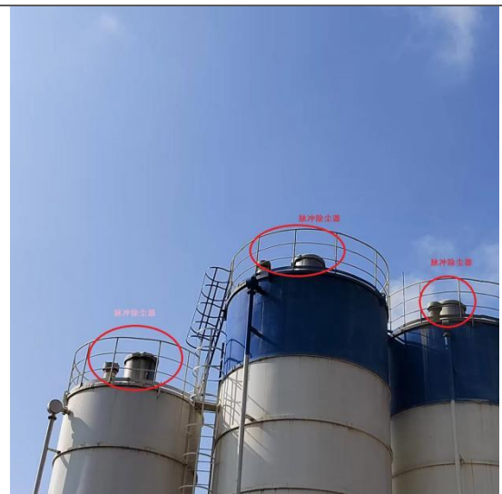
粉料筒仓脉冲除尘器
