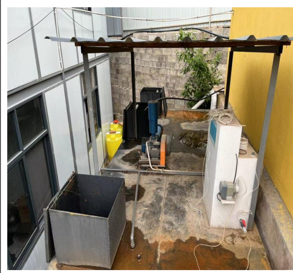
一体化污水站
