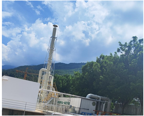
除臭系统及排气筒
