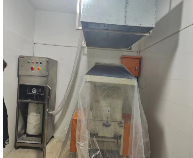
粉碎间集气罩+布袋除尘器
