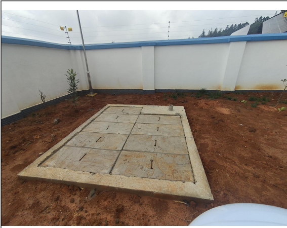
化粪池与收集池
