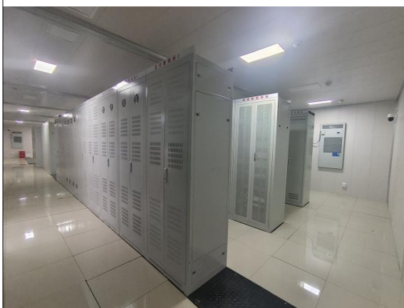
35kV设备室内部
