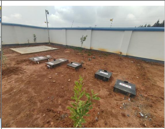
一体化生活污水处理设施
