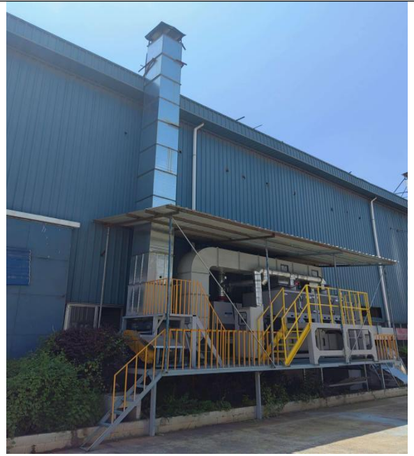
涂装车间排气筒
