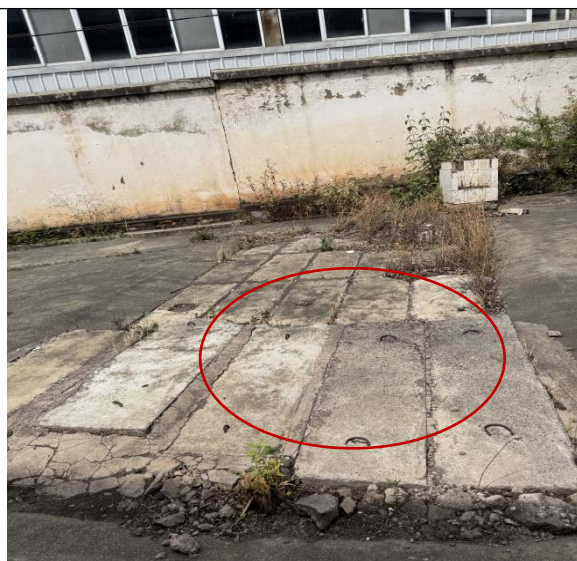
化粪池（涂装车间）
