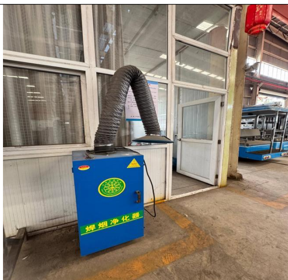
焊接烟尘净化器（制造车间）
