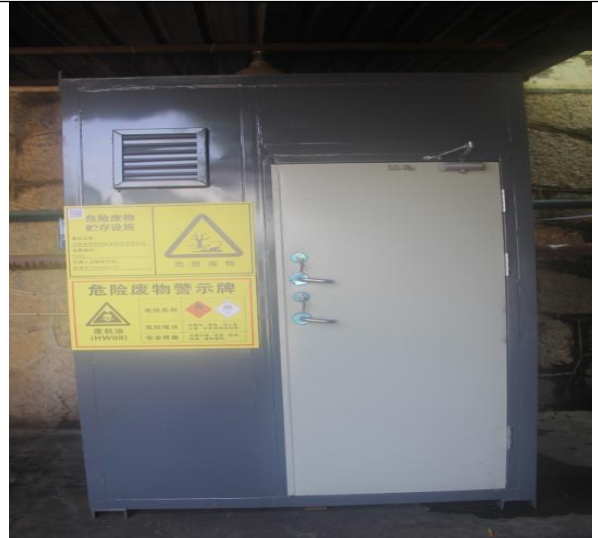
危废暂存间（总装车间）
