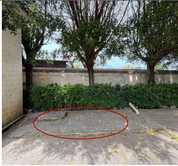
化粪池（总装车间）
