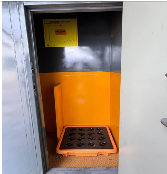
危废暂存间内部（总装车间）
