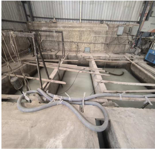
生产废水三级循环沉淀池
