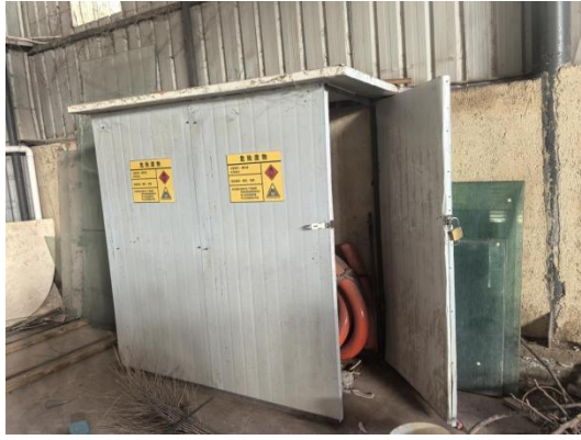
危废暂存间整改前
