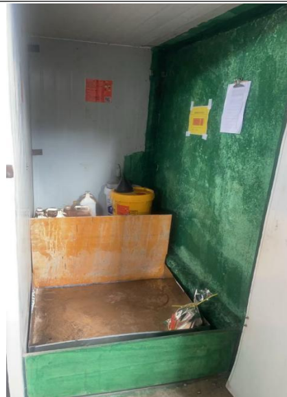
危废暂存间整改后内景
